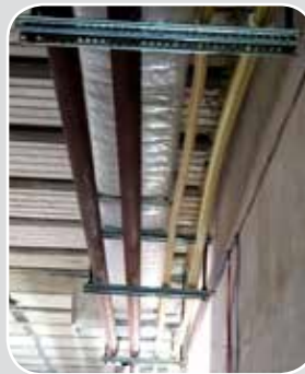
■ اجرای ساپورت دو طبقه جهت کانال‌های هوا رسان و لوله‌های فلزی توسط سوپرفیکس U
