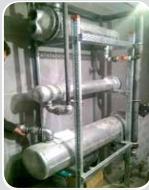
■ اجرای ساپورت خلاقانه جهت تجهیزات مختلف در موتورخانه
