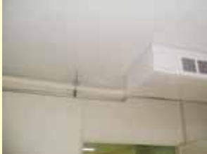
اجرای درست عایق نادرست
