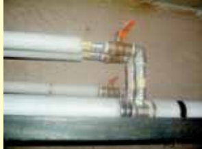
اجرای نادرست عایق نادرست
