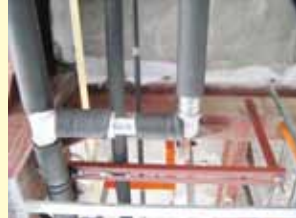
اجرای نادرست عایق درست
