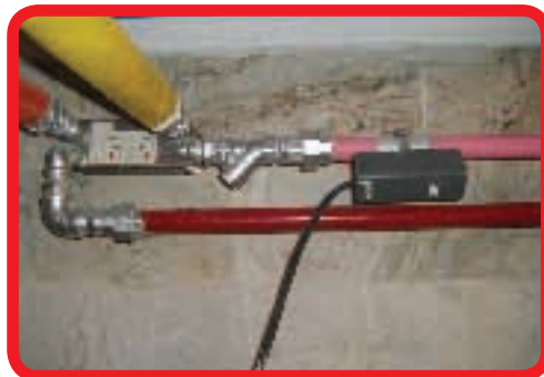
نادرست: نصب افقی مبدل صفحه‌ای
