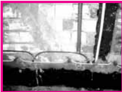
× لوله بصورت افقی روی دیوار اجرا شده است
