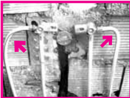
× خم نامناسب موجب دوپین شدن لوله شده است.
