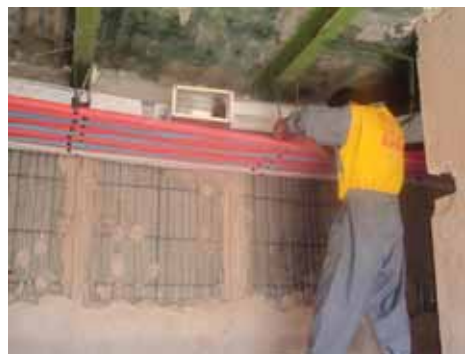
ساپورت بصورت مناسب اجرا شده است
