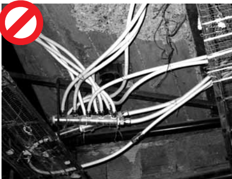
لوله کشی زیر سقف بدون در نظر گرفتن ساپورت مناسب اجرا شده است
