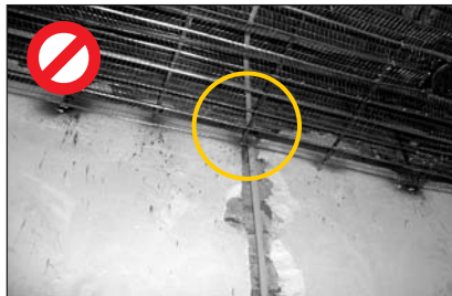
اجرای لوله های سوپرپایپ پیش از جوشکاری انجام شده است و آسیب رسیدگی به لوله ها کاملاً مشهود است.
